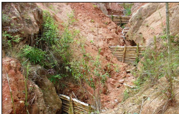
Figura 21-5 - Exemplo de paliçadas rústicas no processo inicial de retenção dos sedimentos (EMBRAPA, 2015)
