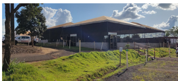
Figura 10. Tenda de 8m x 8m prevista do canteiro comum à barragem B6 e B5
