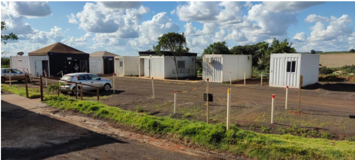
Figura 4-11: Containers voltados para o setor administrativo e fiscalização do canteiro comum ao barramento B6 e B5
