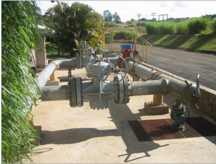
Foto 5.6 – Início do mineroduto (km 0).
