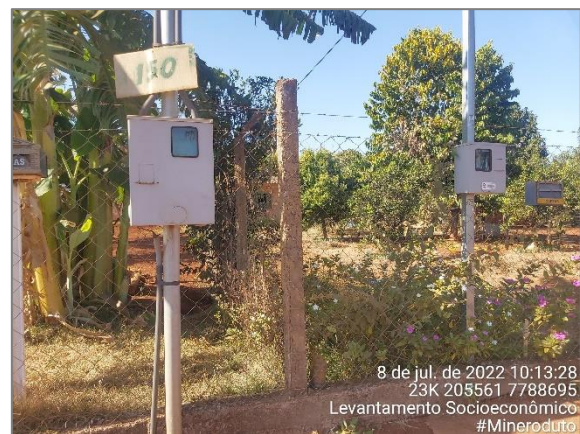
Foto 6.122 – Padrões de entrada de energia elétrica em Delta.
