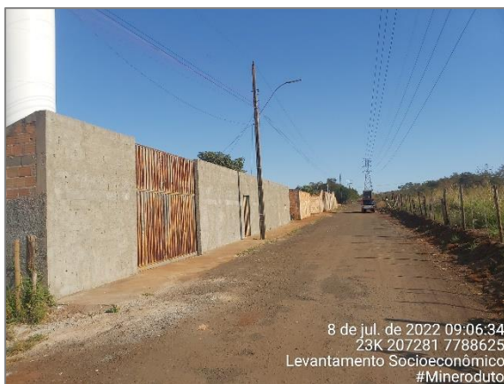
Foto 6.121 – Sistema de distribuição de energia elétrica em Delta.
