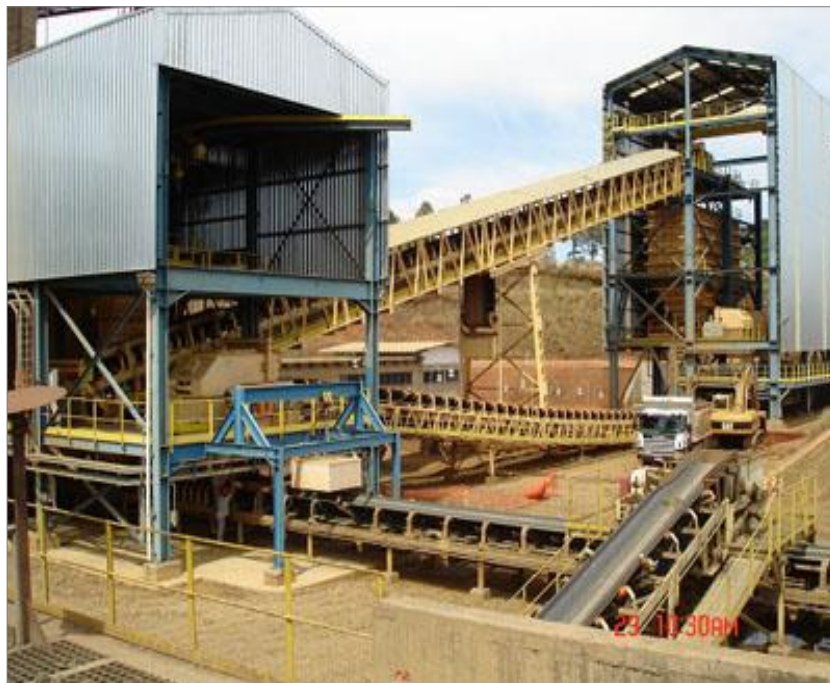
Foto 5.4 – Britagem secundária de minério do CMT.
