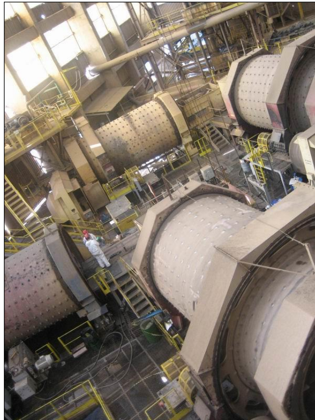
Foto 5.5 – Circuito de moagem.
