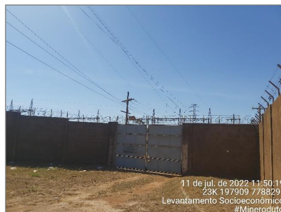
Foto 6.115 – Subestação elétrica no Distrito Industrial III.
