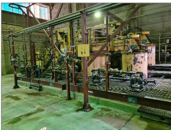
Foto 6.23 – Detalhe do maquinário com caixa de contenção de vazamentos.
