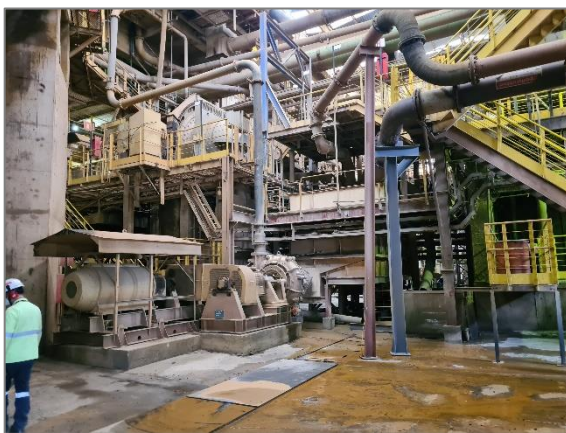
Foto 6.25 – Vista geral das tubulações e maquinário no piso da Usina de moagem.
