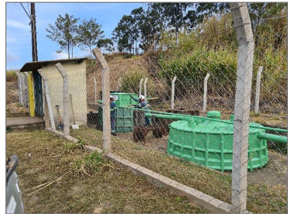
Foto 6.41 – Detalhe dos tanques de tratamento e tubulações do sistema.
