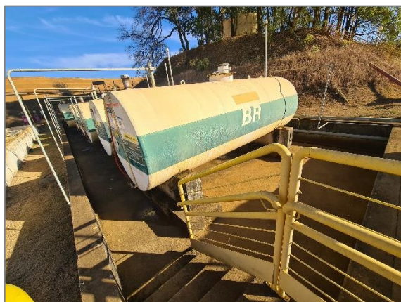
Foto 6.17 – Tanques aéreos de armazenamento de combustível do escritório da Mina.
