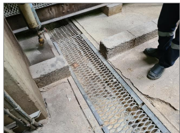
Foto 6.24 – Detalhe de canaletas de coleta e destinação de efluentes de vazamentos.
