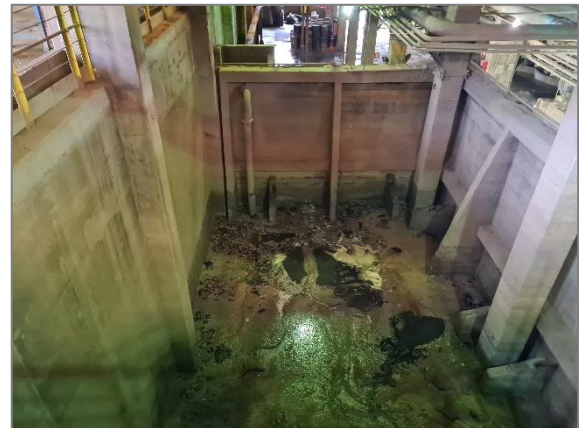
Foto 6.22 – Detalhe de Caixa SAO para contenção de vazamentos.
