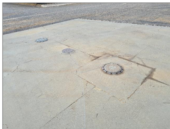
Foto 6.20 – Detalhe de tampas dos tanques aterrados.
