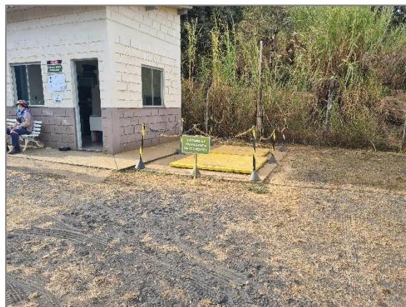
Foto 6.38 – Sistema de tratamento de efluentes por biodigestor.
