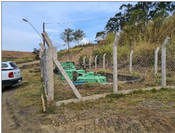
Foto 6.40 – Visão geral da ETE Central.
