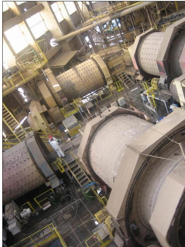
Foto 5.5 – Circuito de moagem.
