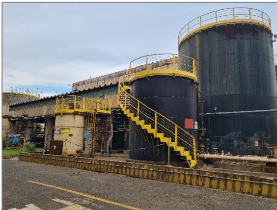
Foto 6.21 – Detalhe de tancagem com caixas de contenção de vazamentos.
