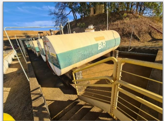
Tanques aéreos de armazenamento de combustível do escritório da Mina.
