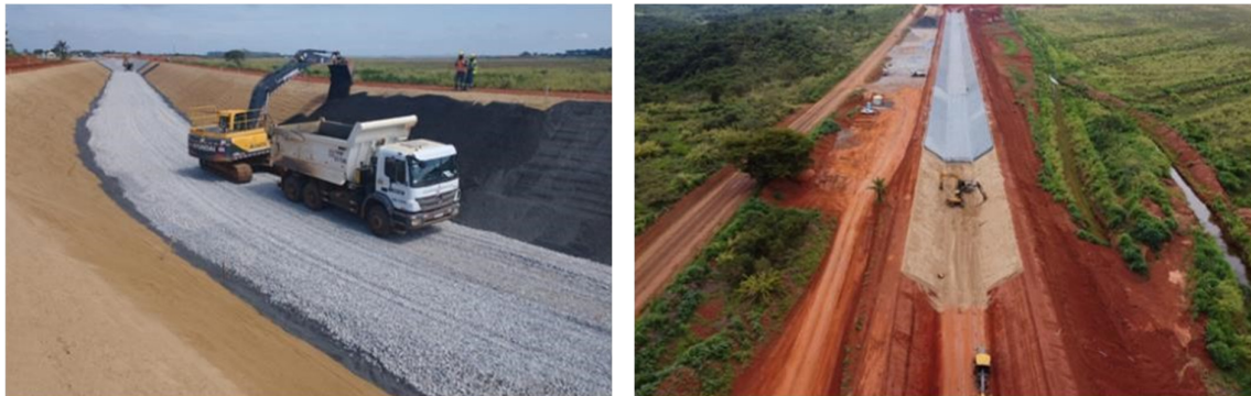
Figura 29 – Aplicação de brita 0 nas paredes do canal periférico e conformação da camada de areia nas paredes.
