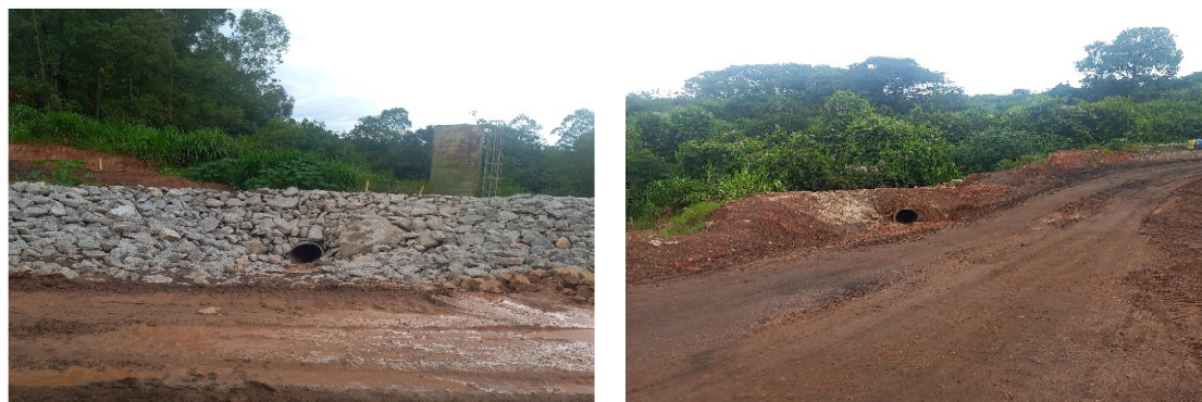
Figura 60 – Construção de passagens molhadas direcionando fluxo para talvegue antigo extravasor na ombreira esquerda e sump existente da ombreira direita.
