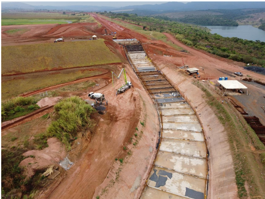
Figura 6.8 – avanço do concreto armado sobre o maciço.
