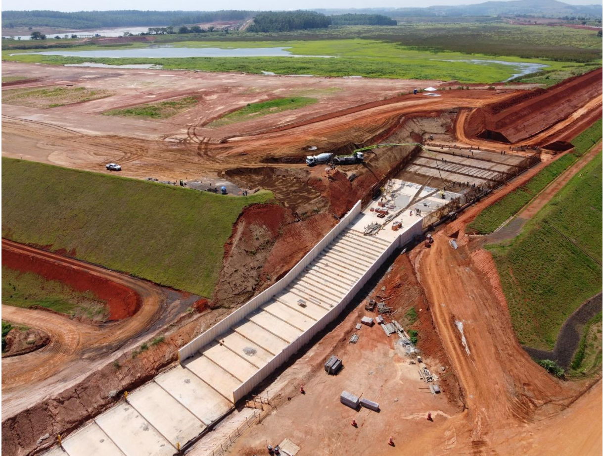
Figura 6.17 – paredes e pisos sobre o maciço.
