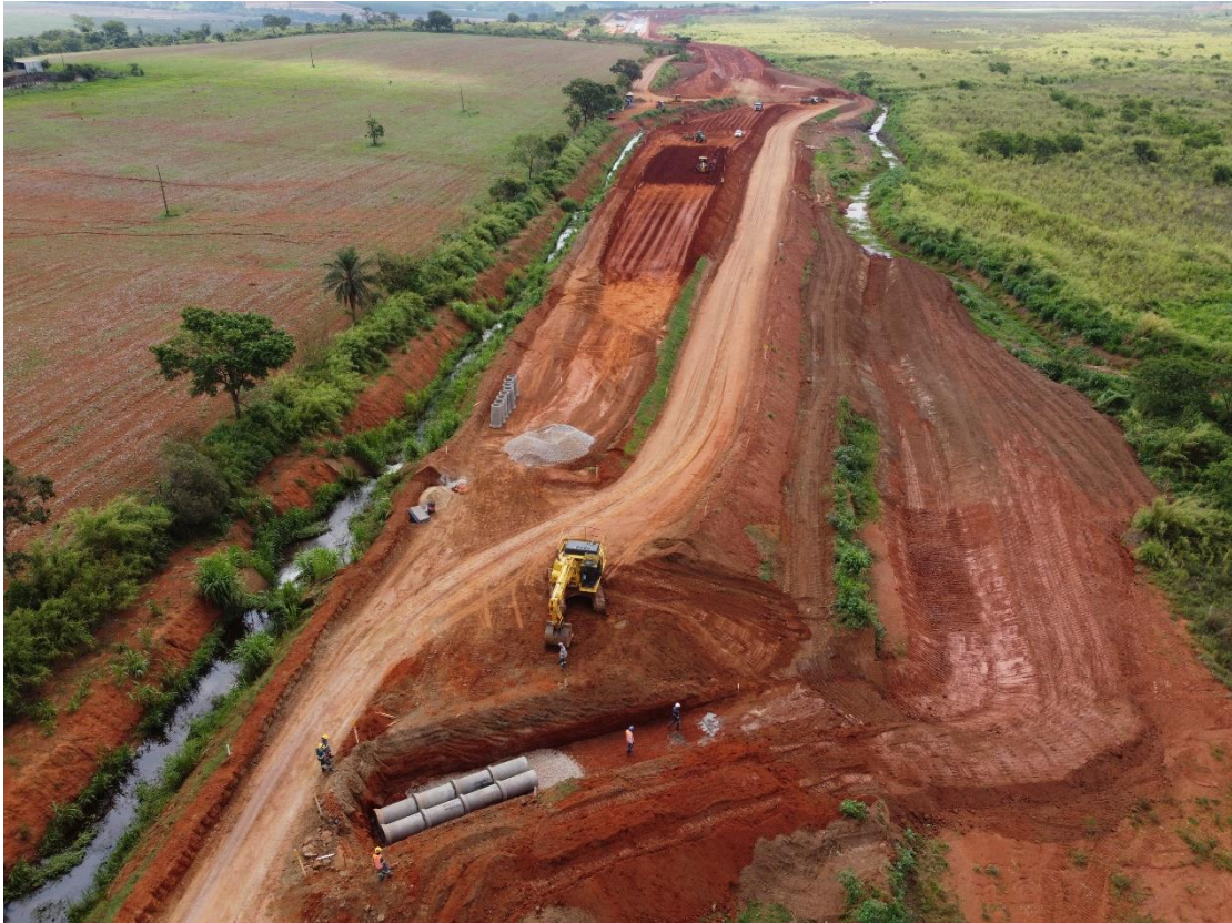
Figura 6.32 – avanço do aterro entre as estacas 42 e 22: desvio do extravasor da barragem B4 para execução do canal periférico sobre o canal existente.
