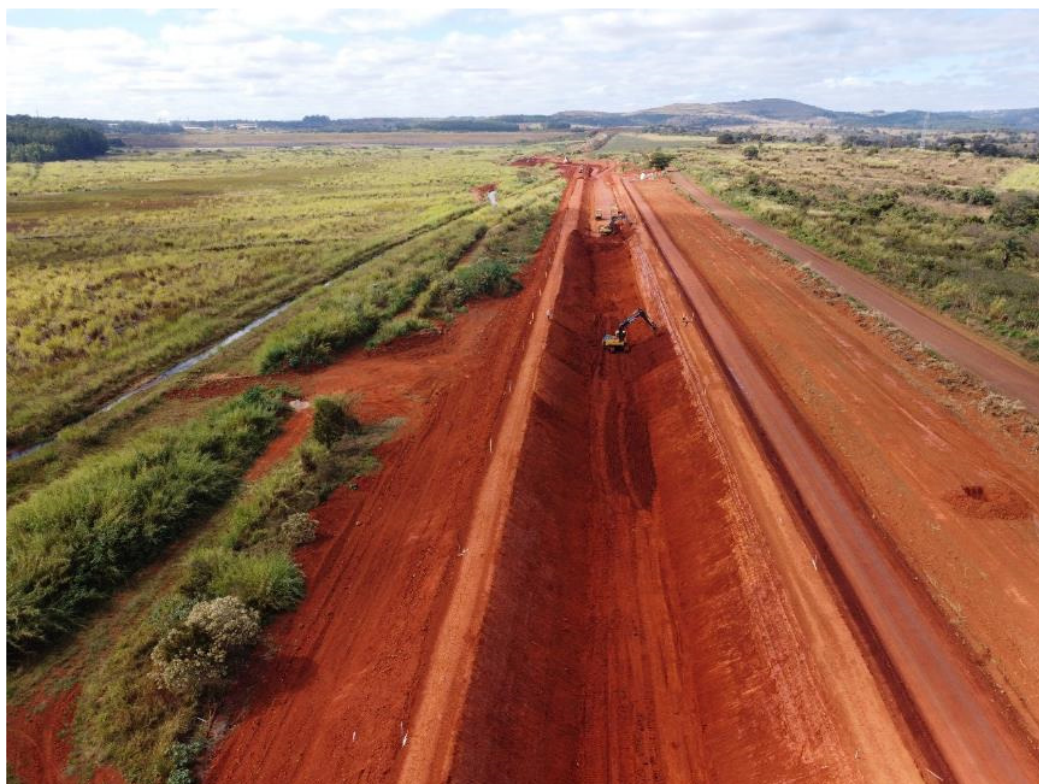
Figura 6.44 – avanço das escavações e aterro do canal periférico entre as estacas E43 e E101.
