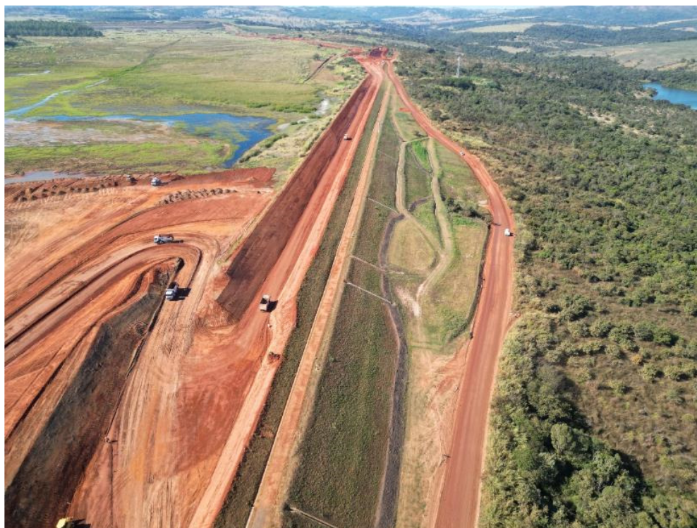
Figura 6.37 – avanço das escavações entre as estacas E135 e E171 – dique lateral barragem B5.
