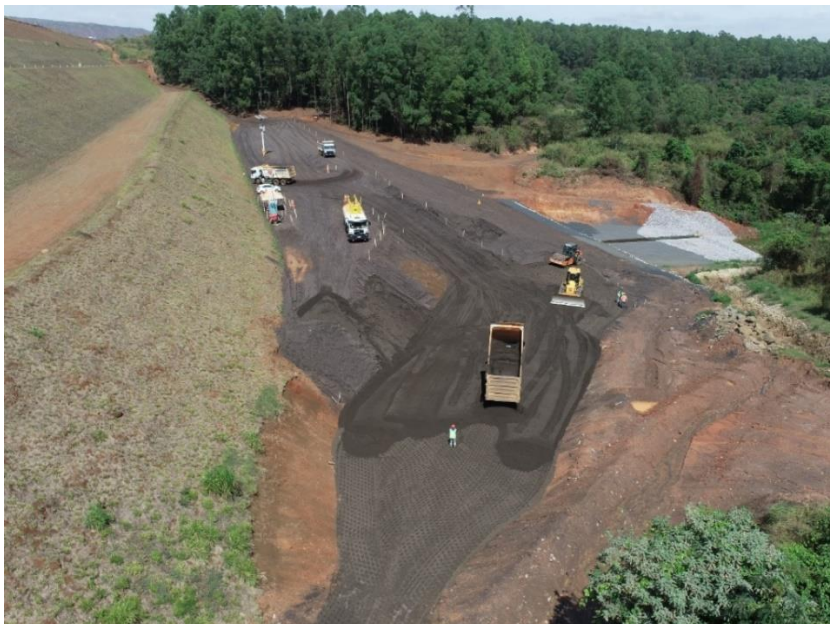
Figura 5.1.14 – Lançamento, espalhamento e compactação de rejeito em magnetita na região da trincheira citada acima
