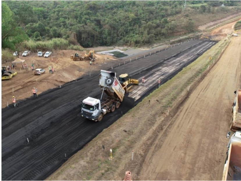
Figura 5.1.13 – Lançamento, espalhamento e compactação de magnetita em paralelo a abertura da trincheira acima
