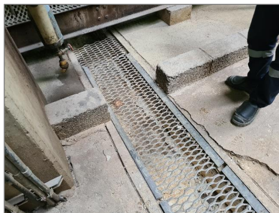
Foto 6.24 – Detalhe de canaletas de coleta e destinação de efluentes de vazamentos.
