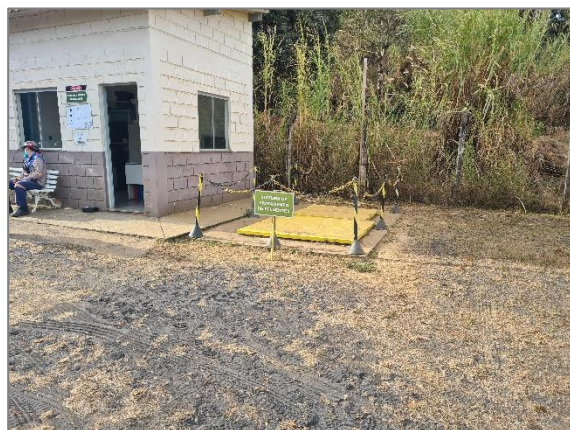
Foto 6.36 – Sistema de tratamento de efluentes por biodigestor.
