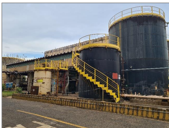
Foto 6.21 – Detalhe de tancagem com caixas de contenção de vazamentos.
