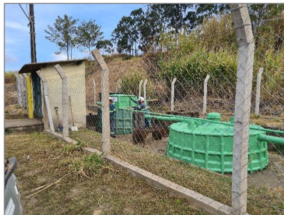
Foto 6.39 – Detalhe dos tanques de tratamento e tubulações do sistema.
