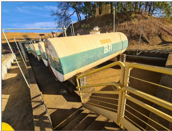
Foto 6.17 – Tanques aéreos de armazenamento de combustível do escritório da Mina.
