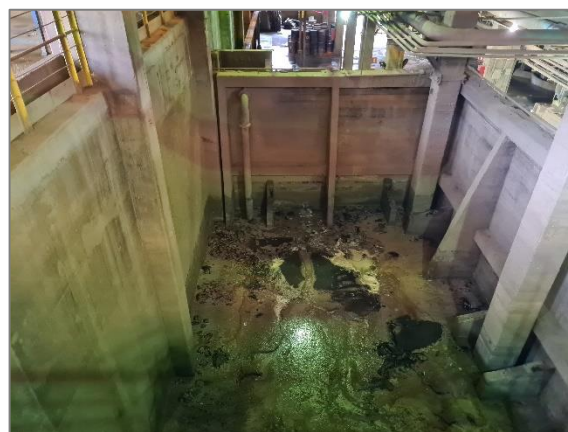
Foto 6.22 – Detalhe de Caixa SAO para contenção de vazamentos.
