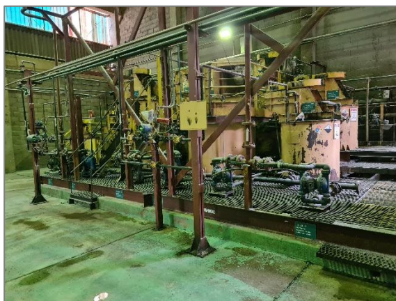
Foto 6.23 – Detalhe do maquinário com caixa de contenção de vazamentos.
