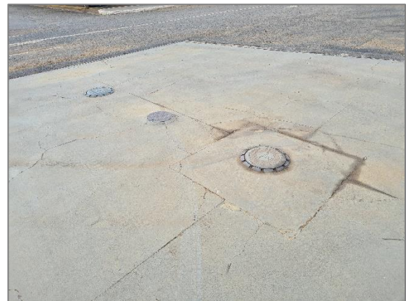
Foto 6.20 – Detalhe de tampas dos tanques aterrados.
