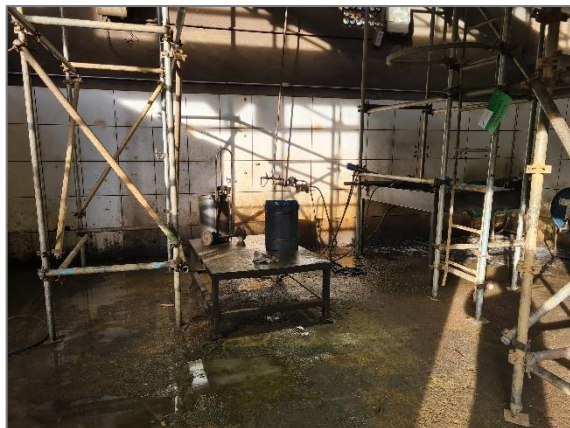
Foto 6.27 – Área de lavagem de peças, com canaletas de coleta de efluentes.
