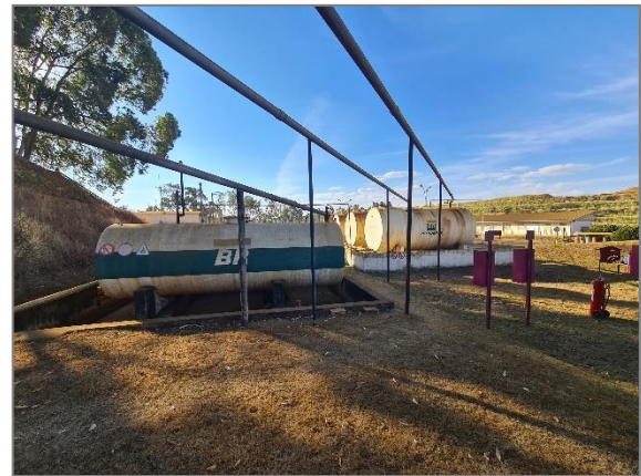
Foto 6.18 – Detalhe de tubulações de abastecimento de tanques do Posto do escritório da Mina.
