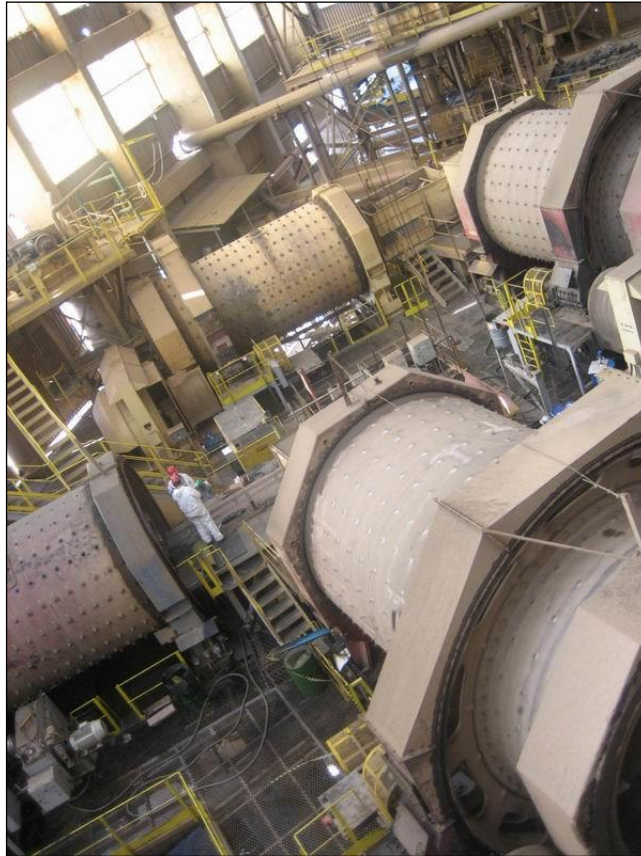
Foto 5.5 – Circuito de moagem.
