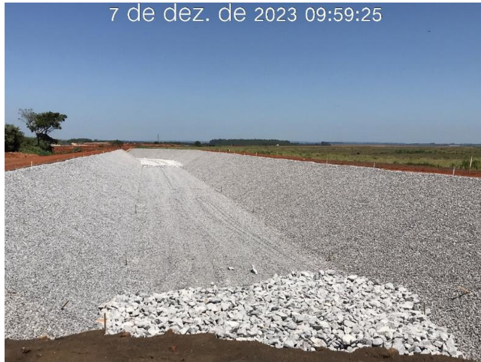
Figura 7.10 – Aplicação da camada de proteção no canal periférico, entre as estacas 46 e 60, com vista para jusante (07/12/2023).
