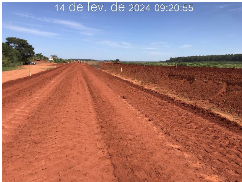
Figura 7.6 – Detalhe da camada de aterro na região da estaca 27 do canal periférico, com vista para jusante (14/02/2024).
