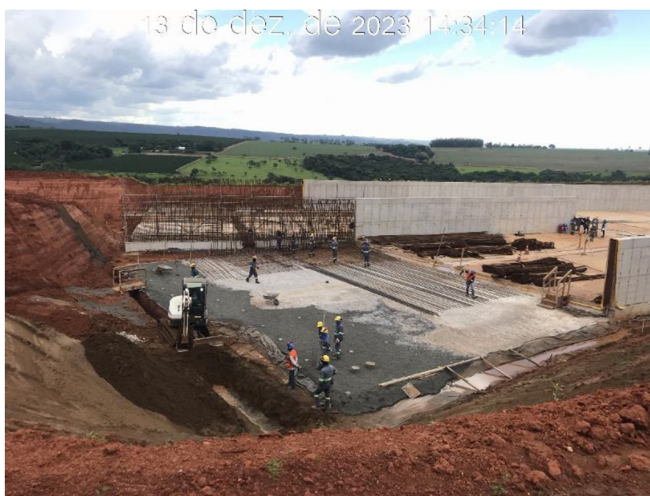
Figura 7.23 – Execução da transição 2 que interliga o canal do reservatório ao canal rápido (13/12/2023).
