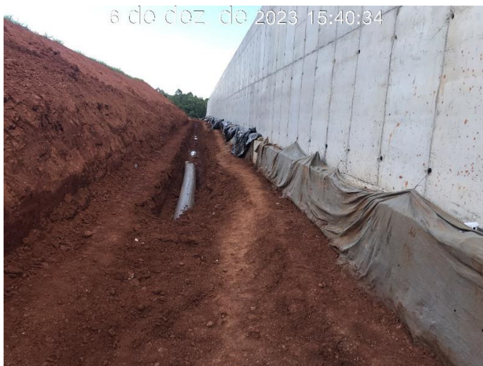
Figura 7.43 – Execução de drenagem provisórias na lateral do canal rápido, entre o módulo 65 e 74, com vista para jusante (06/12/2023).
