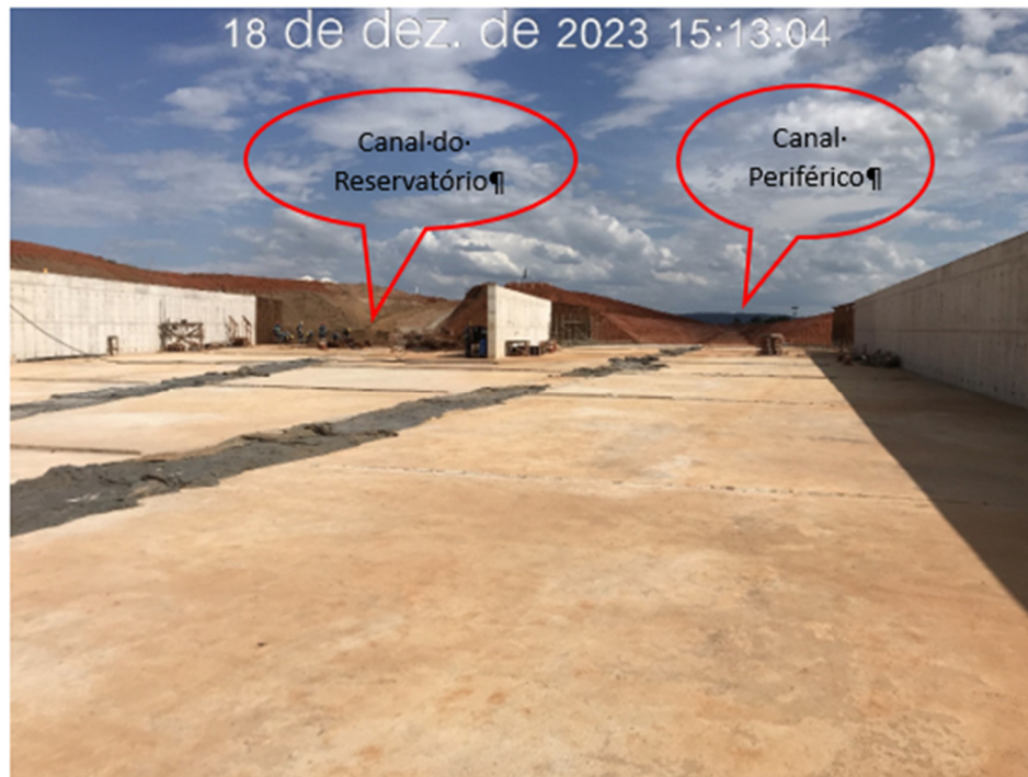
Figura 7.18 – Vista para montante do canal rápido, com detalhe da junção entre o canal periférico e o canal do reservatório (18/12/2023).
