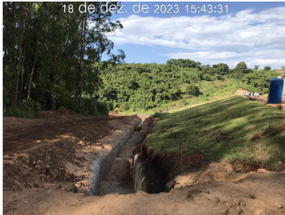
Figura 7.35 – Aplicação do concreto magro no canal de drenagem superficial da ombreira esquerda, entre os módulos 23 e 27 (18/12/2023).
