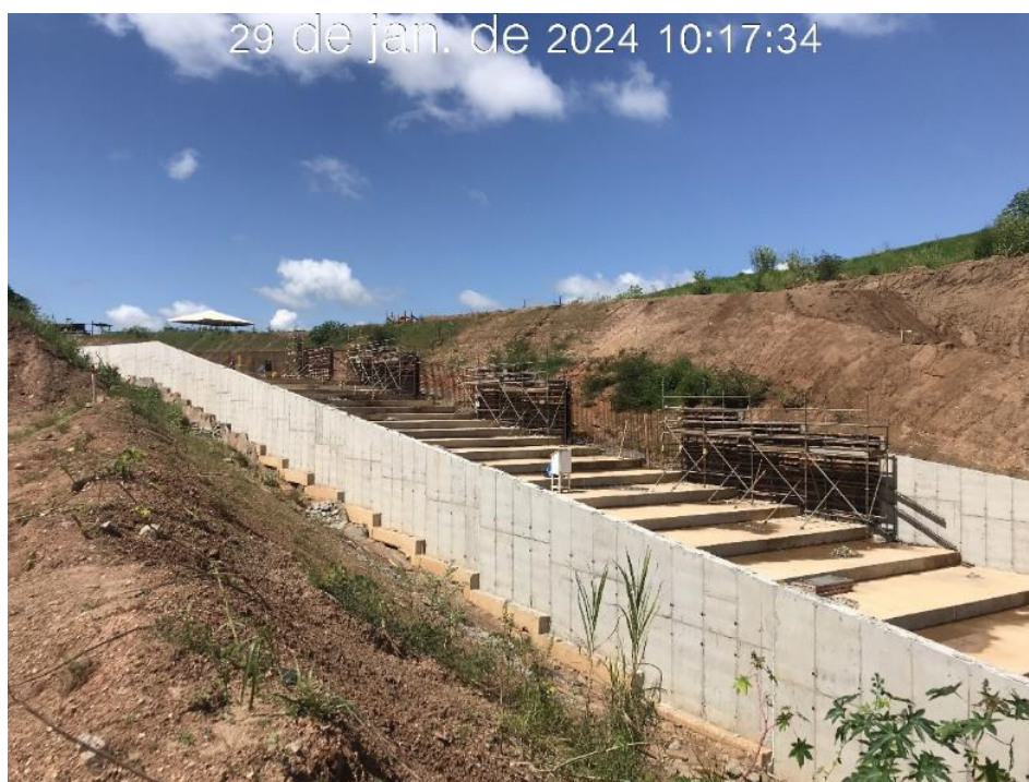
Figura 7.27 – Concretagem das paredes do lado esquerdo do canal rápido entre os módulos 44 e 48, com vista para montante (29/01/2024).
