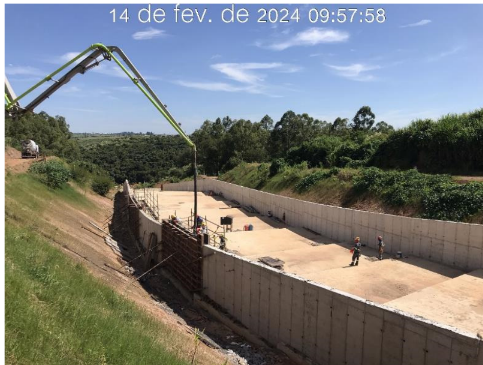
Figura 7.28 – Vista para jusante do canal rápido, com detalhe da concretagem dos módulos 51 e 53 (14/02/2024).
