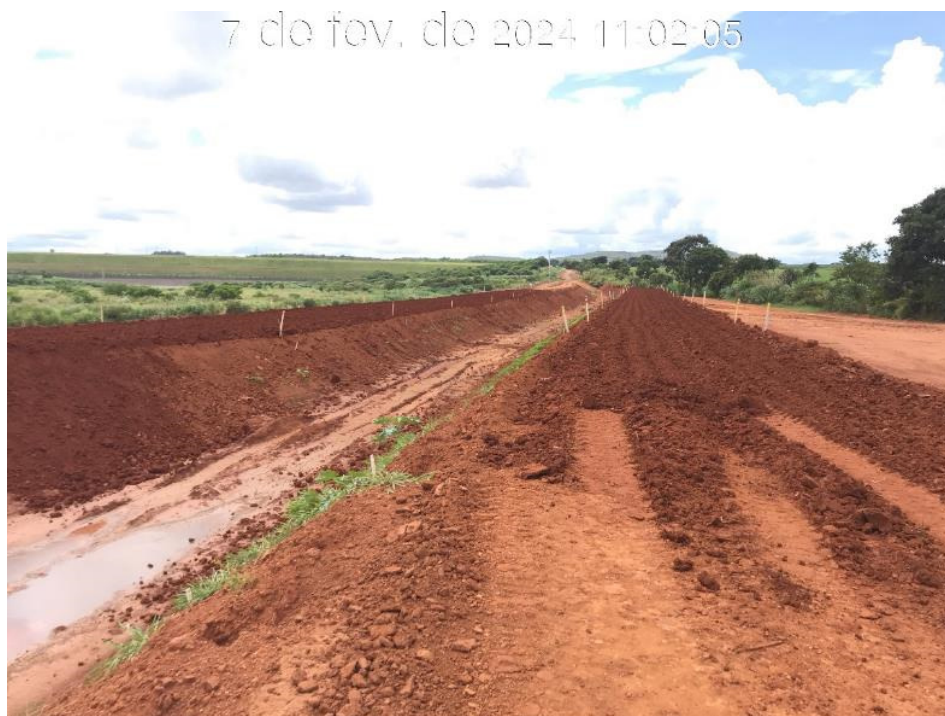
Figura 7.5 - Aplicação de material argiloso na camada de aterro do canal periférico, entre as estacas 22 e 43, com vista para montante (07/02/2024).
