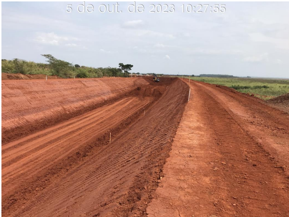
Figura 7.4 – Escavação do canal periférico, entre a estaca 115 e 125, com vista para jusante (05/10/2023).
