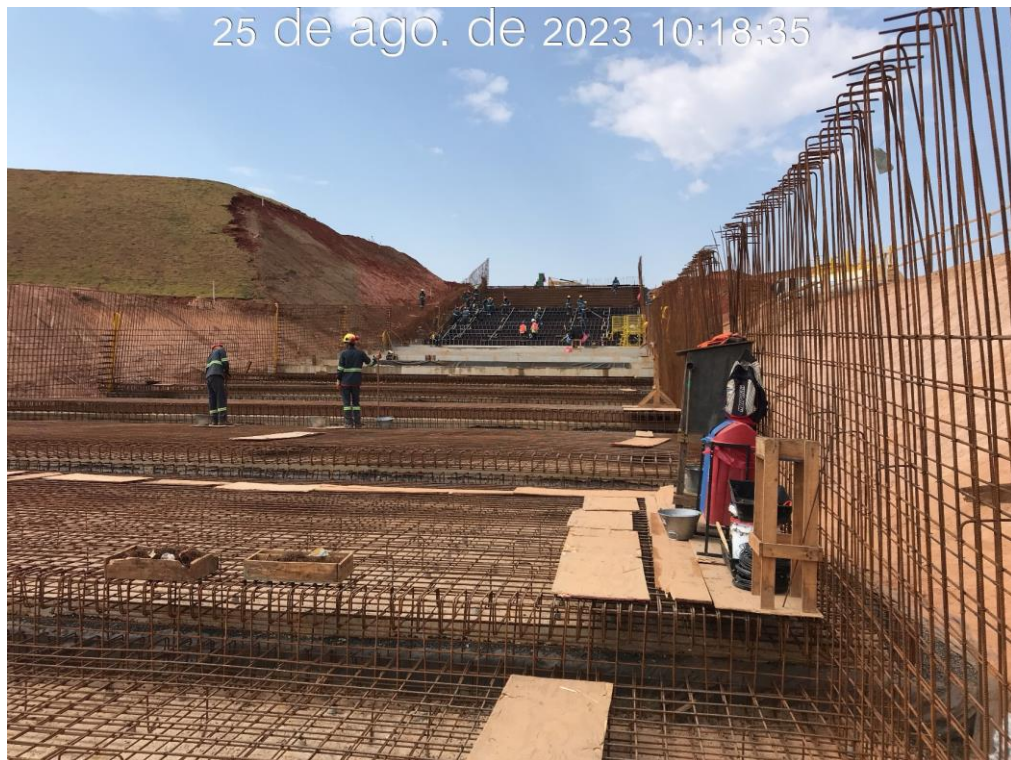
Figura 7.19 – Montagem da armação no piso e nas paredes do canal rápido, entre os módulos 58 e 65 (25/08/2023).
