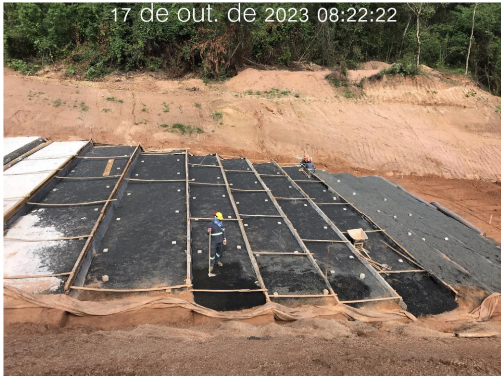
Figura 7.28 – Montagem das formas nos módulos 26 e 27 do canal rápido, para aplicação do concreto magro (17/10/2023).
