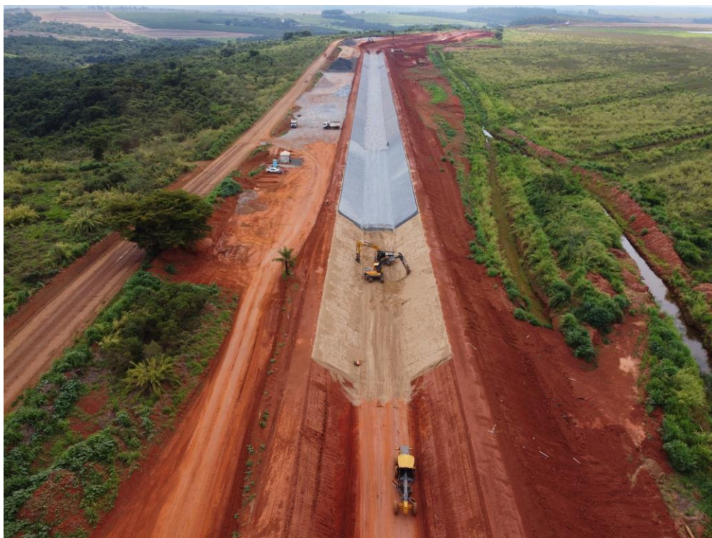
Figura 7.13 – Vista panorâmica do canal periférico, com detalhe das transições entre as estacas 77 e 101, com vista para jusante (27/10/2023).
