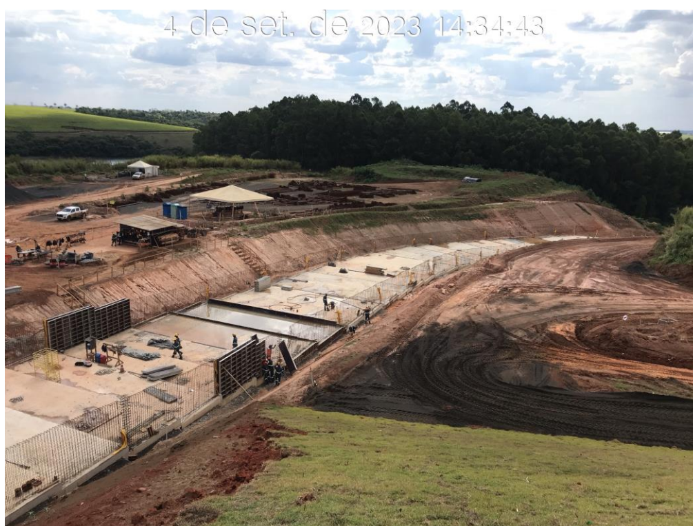
Figura 7.22 – Início da aplicação das formas no módulo 60 do canal rápido, com vista para jusante (04/09/2023).
