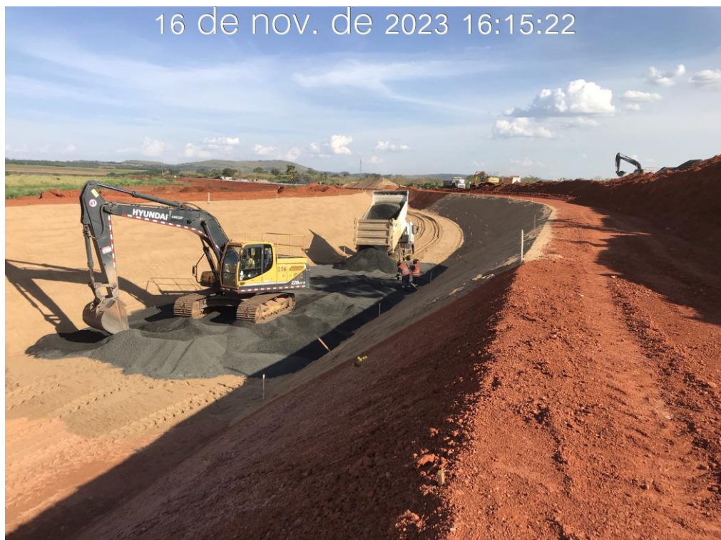
Figura 7.12 – Aplicação das transições do canal periférico, entre as estacas 105 e 120, com vista para montante (16/11/2023).
