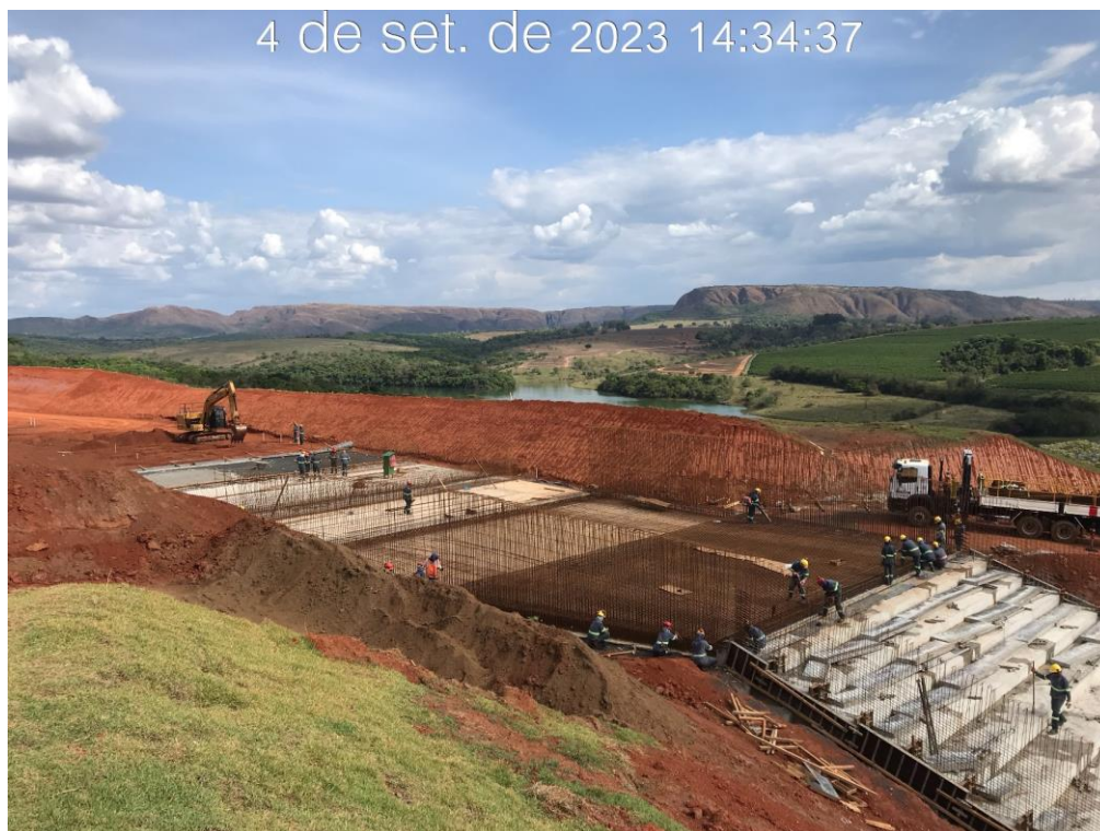
Figura 7.21 – Vista do canal rápido, entre os módulos 68 e 66, com detalhe da montagem da armação no piso e nas paredes (04/09/2023).
