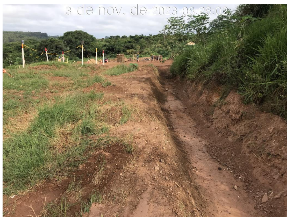
Figura 7.41 – Execução de um canal provisório de desvio de água de chuva, na região da ombreira direita (03/11/2023).
