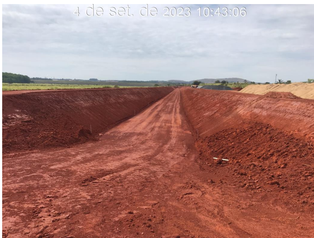
Figura 7.3 – Execução do aterro em material argiloso na estaca 101 do canal periférico, com vista para montante (04/09/2023).
