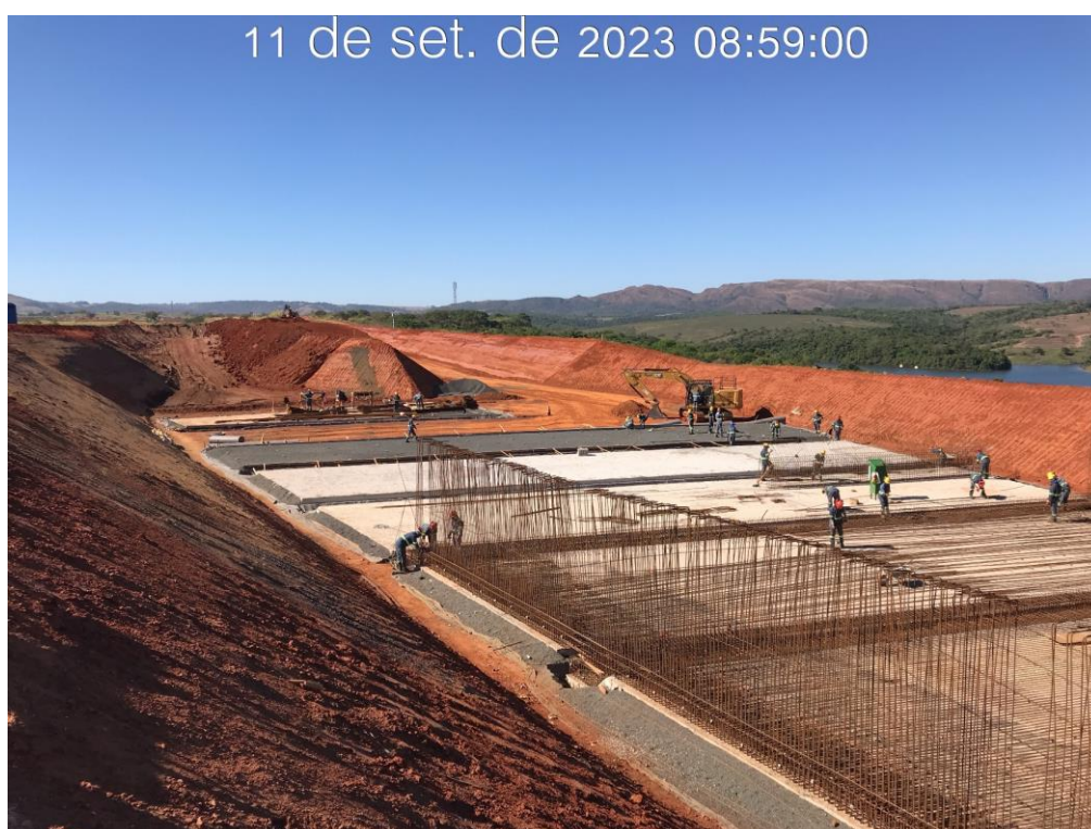
Figura 7.15 – Vista do canal do reservatório, com detalhe da aplicação de brita 0 no dreno de fundo e montagem da armação (11/09/2023).
