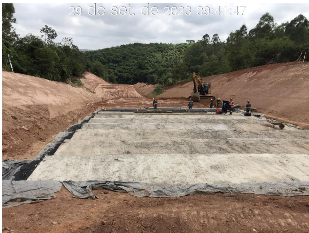
Figura 7.27 – Regularização e aplicação de brita 0 no módulo 33 do canal rápido, com vista para jusante (29/09/2023).
