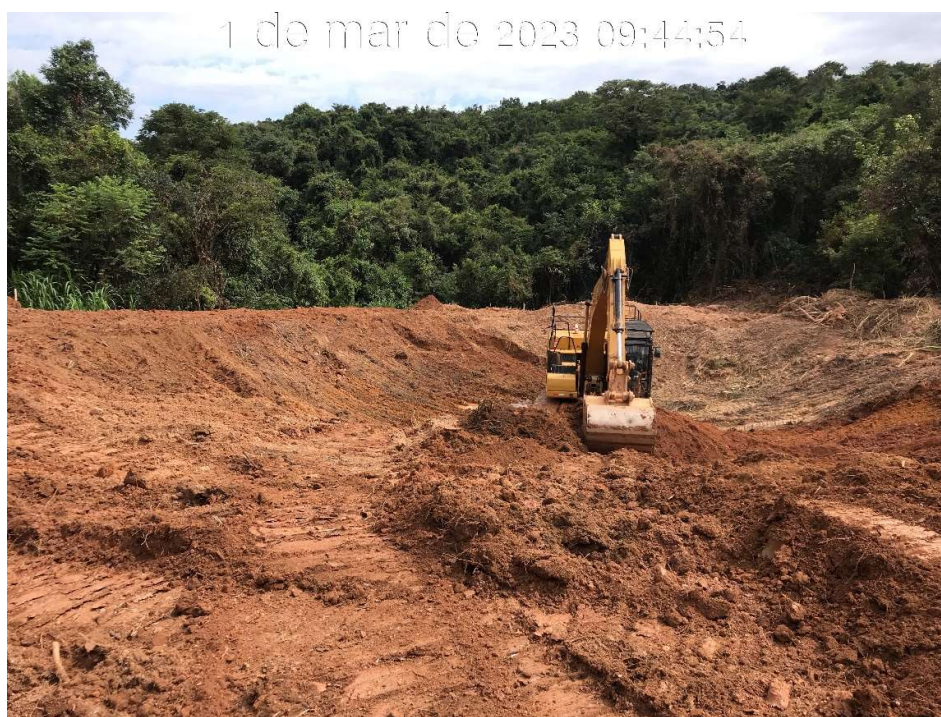
Figura 7.46 – Regularização e limpeza do canal rápido na estaca 200, com vista para jusante (01/03/2023).
