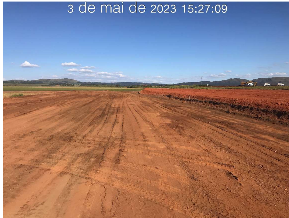
Figura 7.22 – Detalhe do septo argiloso em contato com a praia da B5 (03/05/2023).
