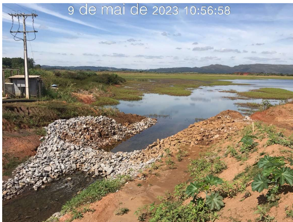
Figura 7.16 – Adequação do dique de enrocamento para rebaixamento do nível de água do reservatório (09/05/2023).
