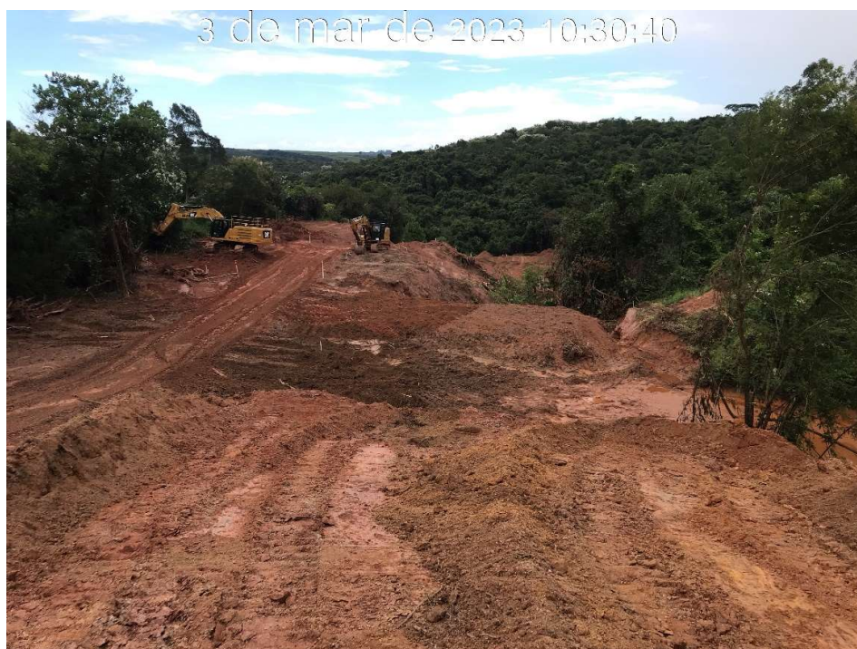
Figura 7.48 – Regularização e limpeza vegetal do canal rápido na estaca 195, com vista para jusante (03/03/2023).
