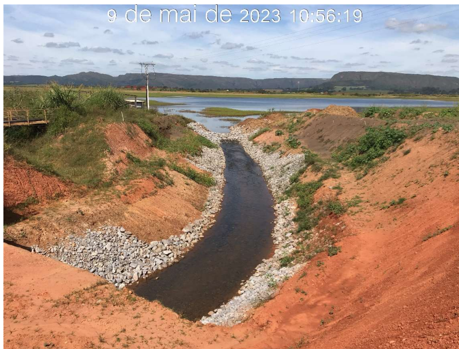
Figura 7.17 – Canal de aproximação em operação, com vista para o reservatório (09/05/2023).
