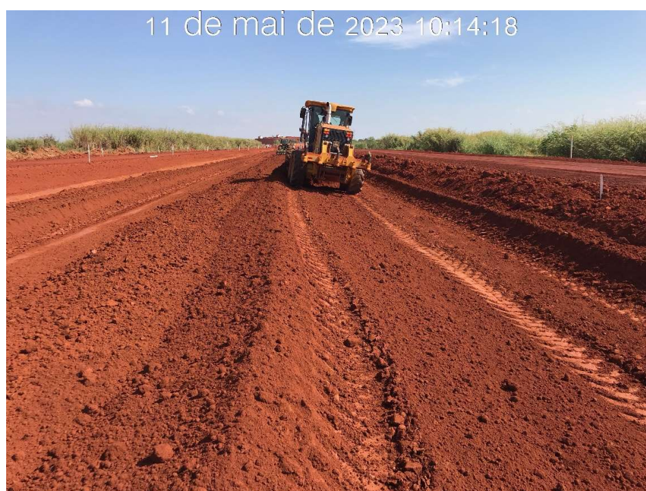
Figura 7.34 – Aplicação de material argiloso no aterro do canal periférico, na estaca 76, com vista para jusante (11/05/2023).
