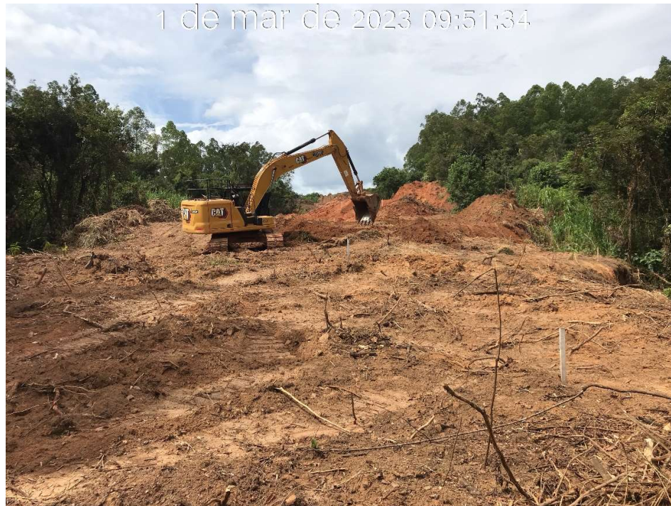
Figura 7.47 – Regularização e limpeza do canal rápido na estaca 200, com vista para montante (01/03/2023).
