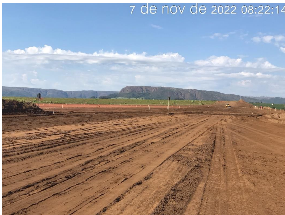
Figura 7.28 - Rebaixamento da crista da Barragem B5 para readequação para linha de centro na ombreira esquerda (07/11/2022).
