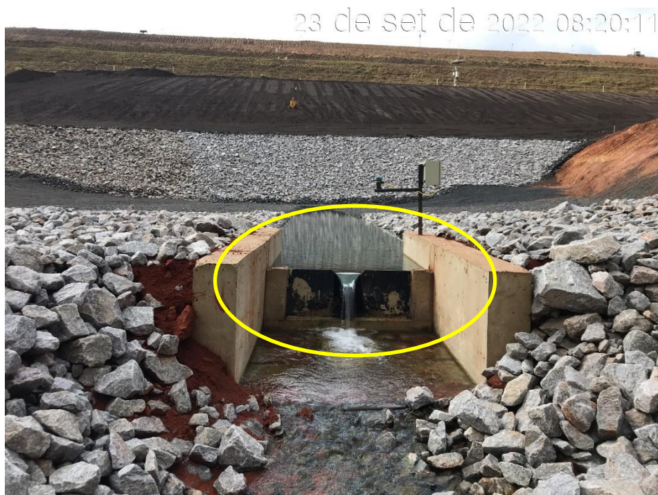
Figura 7.25 - Medidor de vazão MV 01 (23/09/2022).
