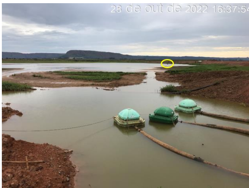
Figura 7.8 - Readequação das bombas de recalque com capacidade de 4.000 m 3 /h, conforme especificação técnica (28/10/2022).
