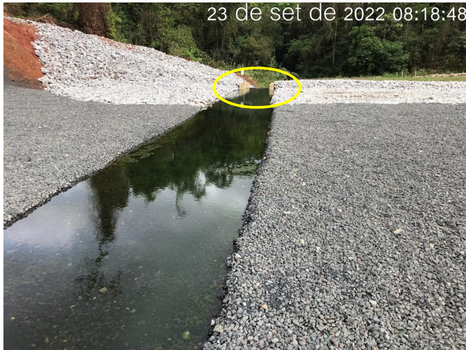
Figura 7.24 - Medidor de vazão MV 01 (23/09/2022).
