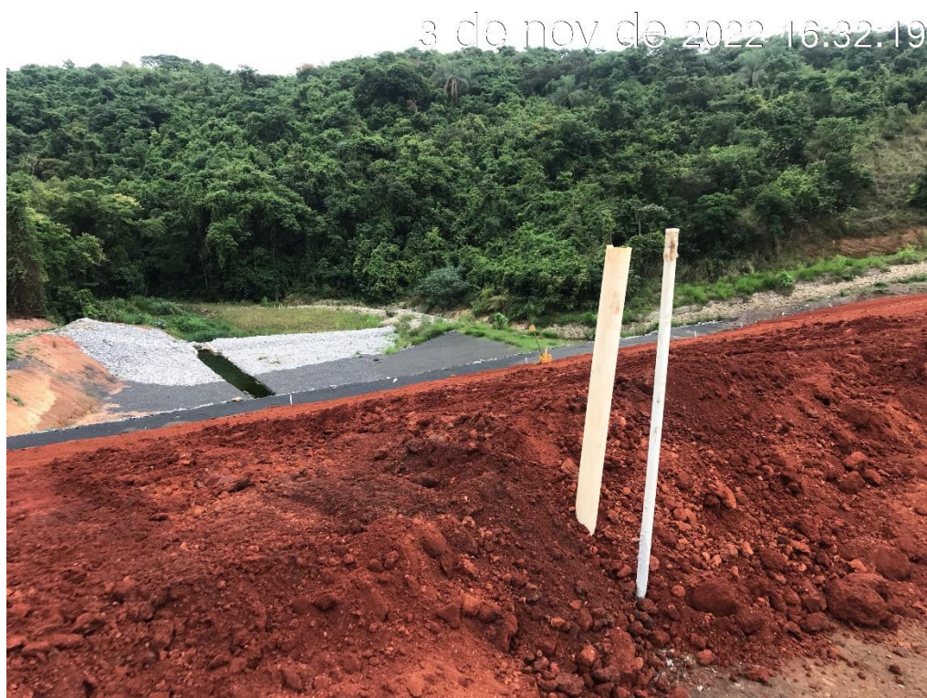
Figura 7.37 – Instalação do INA01, localizado acima do dreno de fundo da Barragem B5 (03/11/2022).
