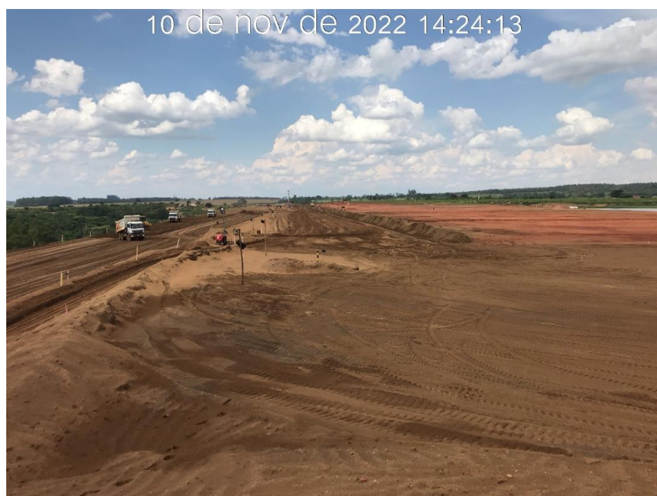
Figura 7.30 - Aplicação do material de rejeito Underflow e do rebaixamento da crista para readequação para linha de centro (10/11/2022).
