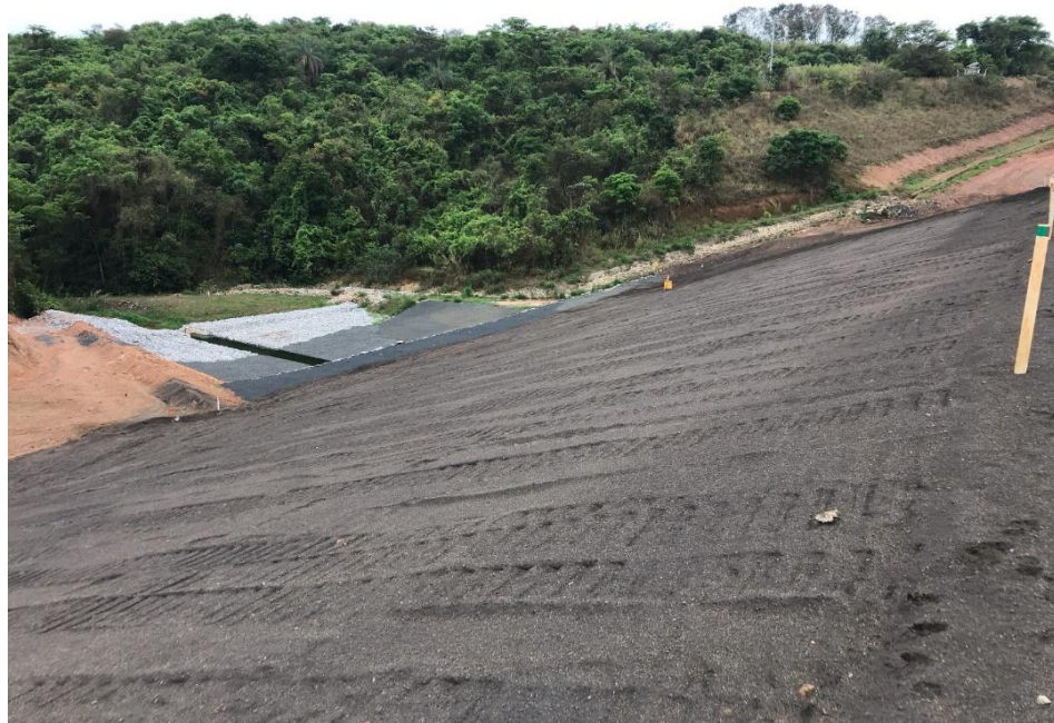
Figura 7.20 - Reforço de pé, com vista para o MV 01 (30/09/2022).
