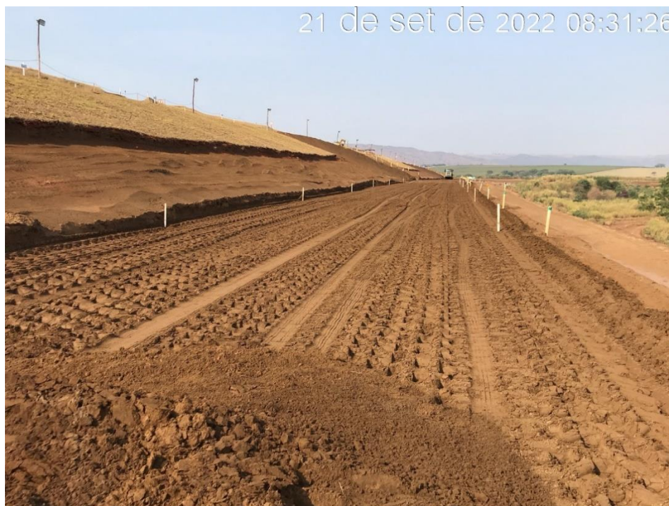
Figura 7.27 - Aplicação do material de rejeito Underflow para regularização do alteamento para linha de centro, elevação 952,50m (21/09/2022).
