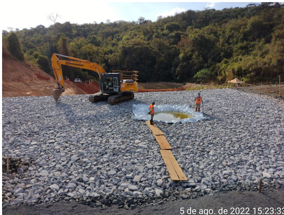
Figura 7.13 - Realização do ensaio de controle de compactação do enrocamento, determinando a densidade pelo método da membrana plástica (05/08/2022).
