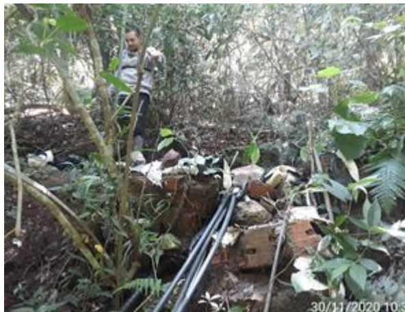
Foto 6.9: Adutoras de captação (CMT-NA-49).
