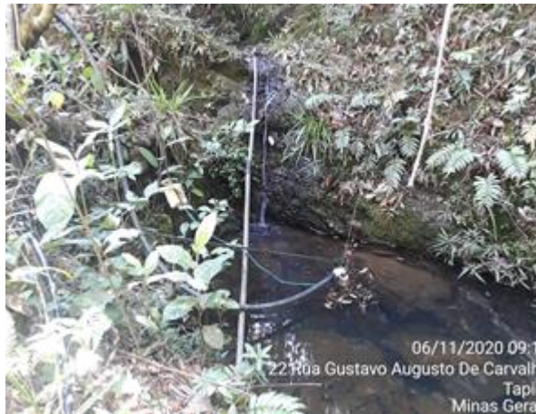
Foto 7.19: Captação em drenagem fio d'água por bombeamento (CMT-US-05).
