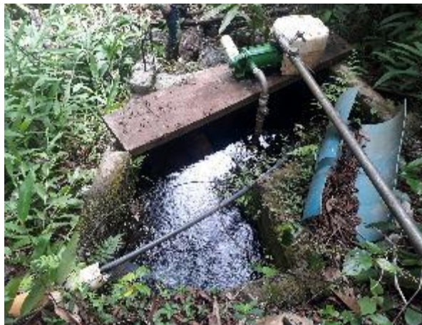
Foto 6.71: Captação em drenagem, a jusante do NA-32.
