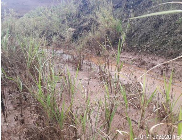
Foto 6.87: Surgência em solo silto-argiloso (CMT-NA-69).
