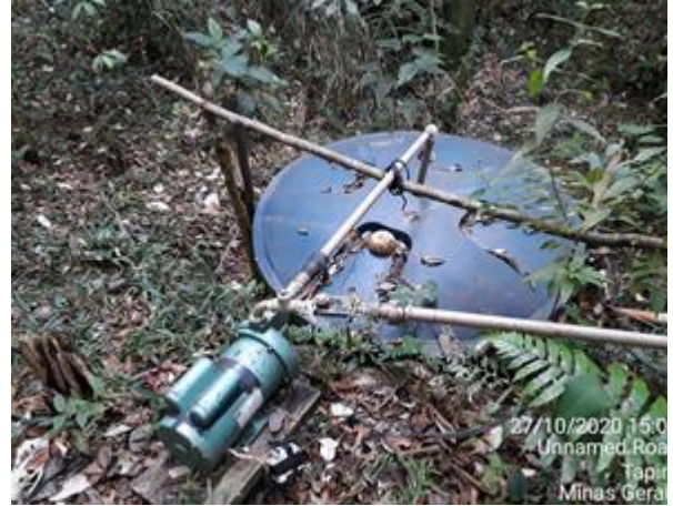
Foto 6.32: Captação por bombeamento à jusante da surgência (CMT-PC-10).
