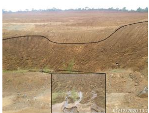
Foto 6.98: Face do talude encharcada, com pontos de surgência (CMT-PC-24).
