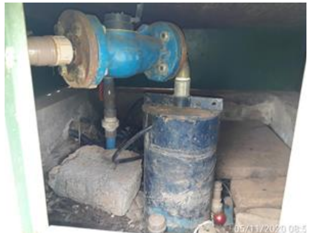
Foto 7.6: Poço tubular profundo – 195 metros (CMT-US-03B).
