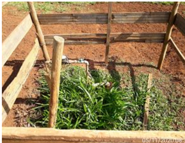
Foto 7.5: Poço tubular profundo – 45 metros (CMT-US-03A).
