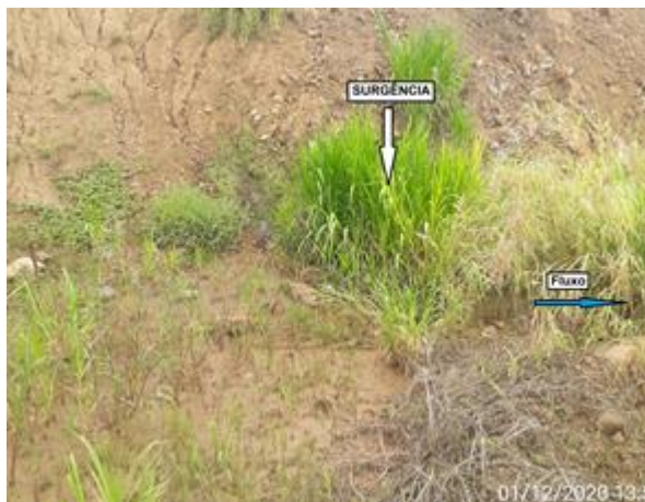
Foto 6.99: Ponto de surgência difusa em talude a nordeste do SUMP (CMT-PC-25).
