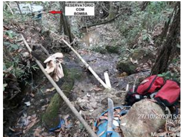
Foto 7.20: Captação em drenagem fio d'água por bombeamento (CMT-US-02).
