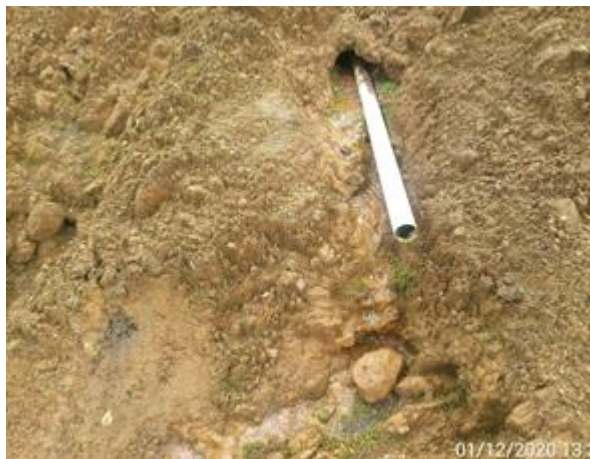
Foto 6.97: Escoamento de água em local de DHP (CMT-PC-24).
