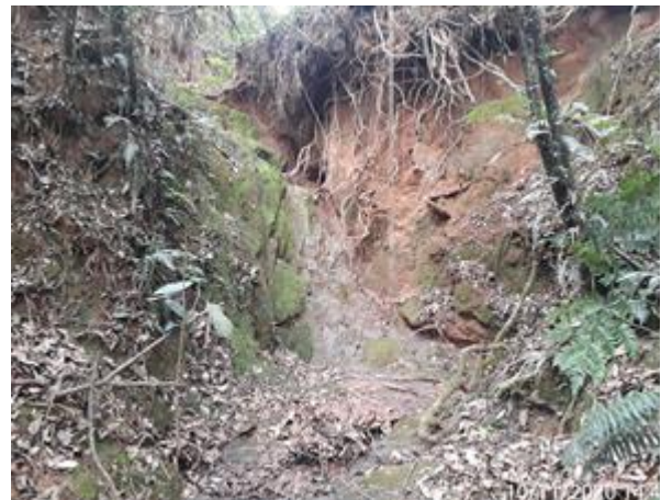
Foto 6.58: Montante com erosão (CMT-NA-21).
