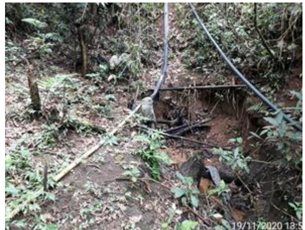
Foto 6.38: Adutora de 300 mm que faz reposição na cabeceira do córrego Canoas (CMT-PC-20).
