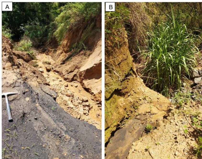
Figura 8.8 - (A) Erosão no colúvio e solo residual em talude. (B) Erosão do colúvio em drenagem.
